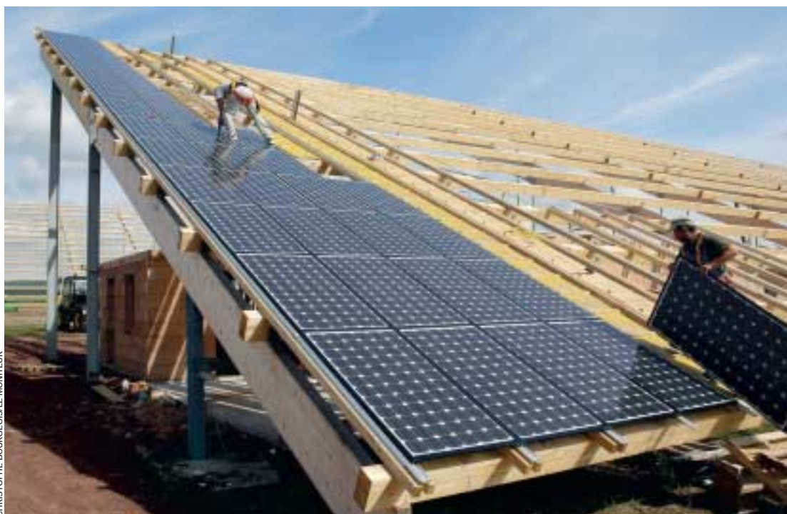
A Weinbourg (Bas-Rhin), cinq hangars agricoles aux toitures photovoltaïques sont en chantier. Ils serviront à stocker, sécher et transformer en granulés des plantes énergétiques et des déchets forestiers destinés aux chaufferies collectives locales.
